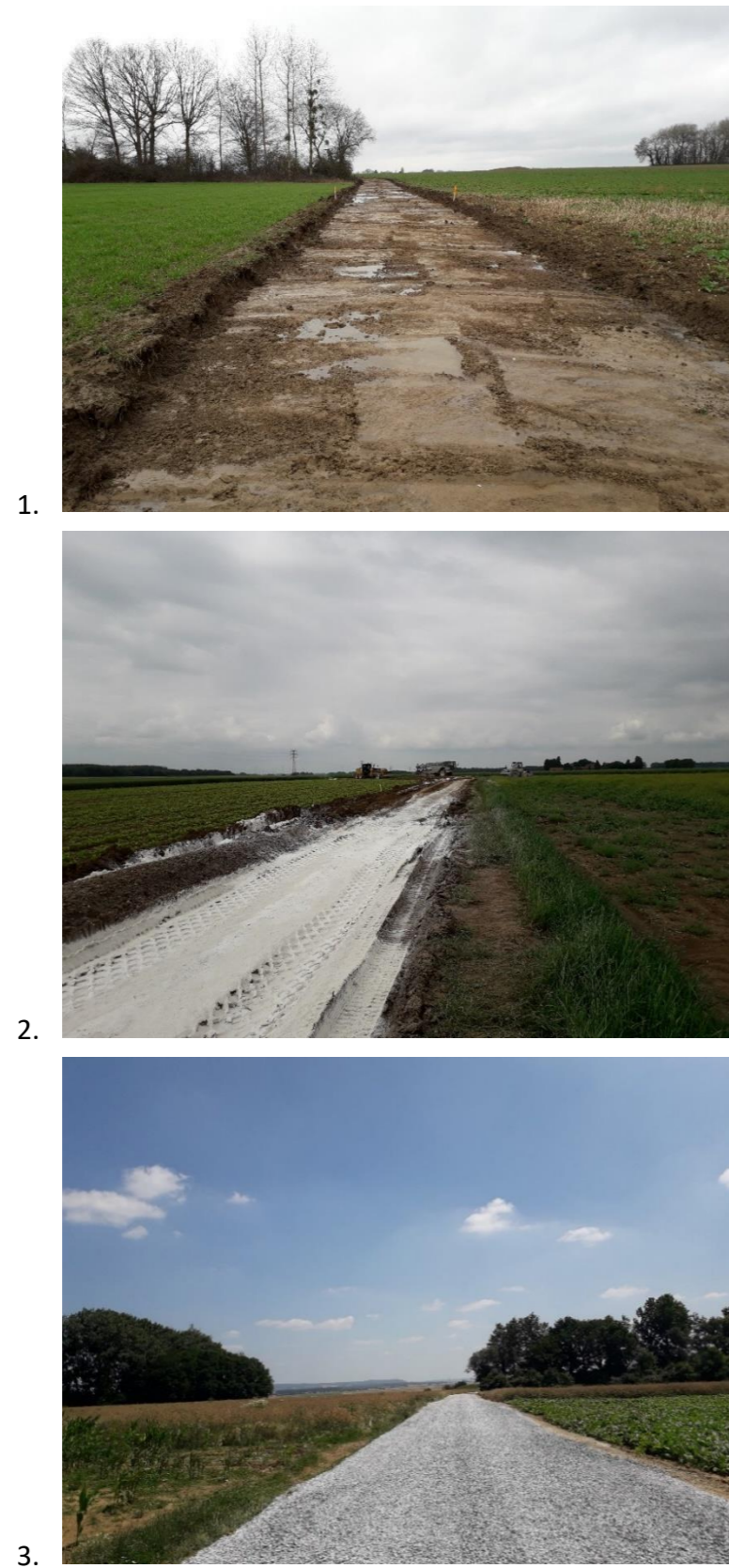
Figure 63 : Création de chemin 1 - Décapage, 2- Traitement à la chaux, 3 – Etat final (Source : VOLKSWIND)
